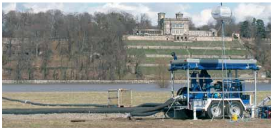
Herzstück der Fachgruppe Wasserschaden/Pumpen ist eine Anhängerpumpe 15.000 l pro Minute, hier bei einem Hochwassereinsatz 2006 an der Elbe bei Dresden.
